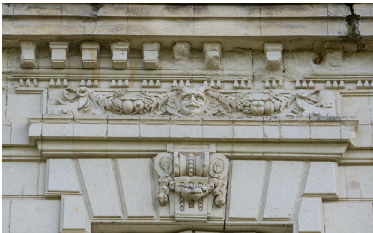
Un détail d'un linteau, d'une agrafe et de la corniche de l'élévation antérieure.
