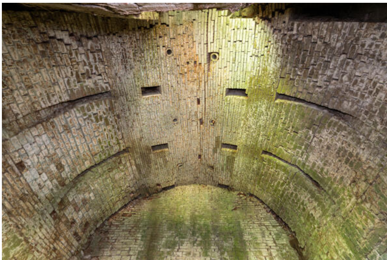
Le four : intérieur de la chambre de cuisson, voûte et événements.
