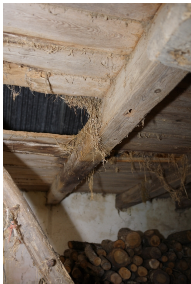
Détail des trous de mortaises dans une solive attestant de la présence d'une cloison en pan-de-bois.
