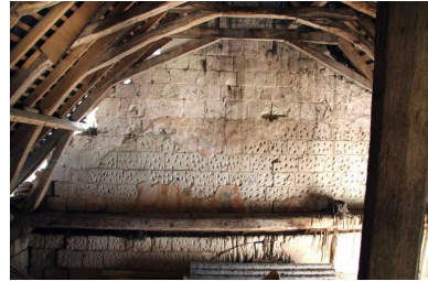
Pignon de l'arc diaphragme couvert de peintures. Phot. Jean-Baptiste Darrasse IVR52_20077200307NUCA
