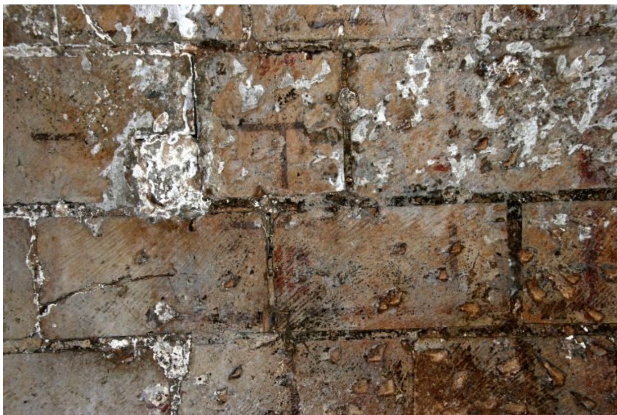
Mur gauche de la nef, détail : traces de faux appareils.
