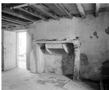
Cheminée placée contre le mur est du rez-de-chaussée du moulin. Phot. François Lasa IVR52_20015300599X
