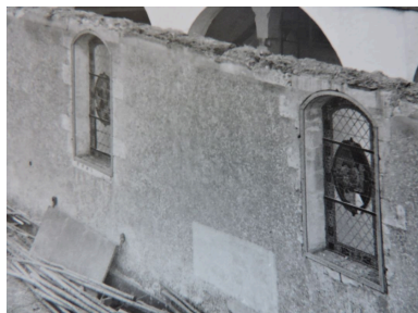
Verrières encore en place sur le mur sud lors de la démolition de l'église, janvier 1974. Phot. Yannis (reproduction) Suire, Phot. André Laurent IVR52_20198503989NUCA
