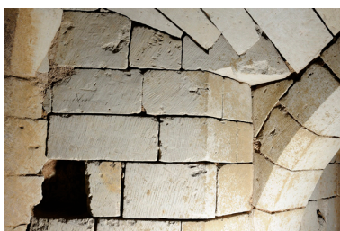
Articulation entre les voûtes de la descente et du palier du second sous-sol : détail de la stéréotomie et du layage. Phot. Bruno Rousseau, Phot. Youenn Communeau IVR52_20114902214NUCA
