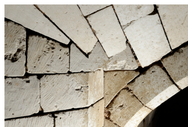
Articulation entre les voûtes de la descente et du palier du second sous-sol : détail (2). Phot. Bruno Rousseau, Phot. Youenn Communeau IVR52_20114902216NUCA
