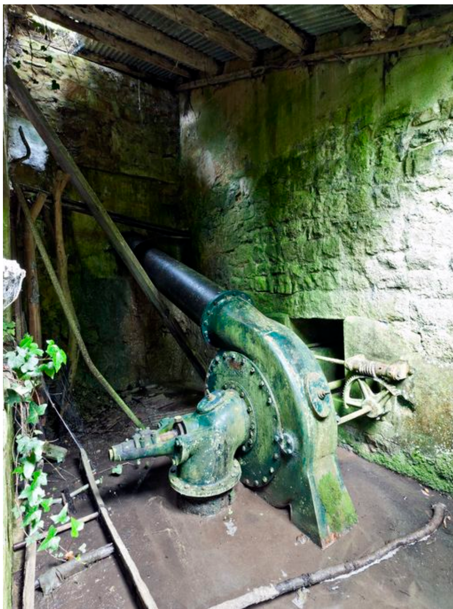
La turbine hydraulique
