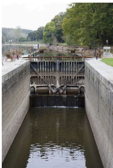
Le sas de l'écluse et la porte amont vus depuis le sud, pendant les écoures de 2009. Phot. Yves Guillotin IVR52_20095300445NUCA
