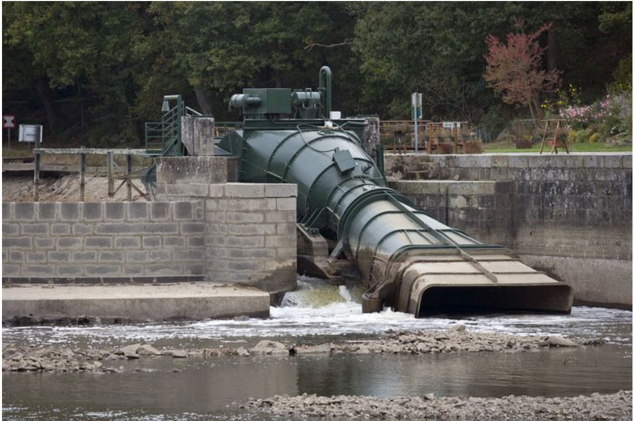
La micro-centrale hydroélectrique vue de trois-quarts depuis l'aval, pendant les écourues de 2009.
