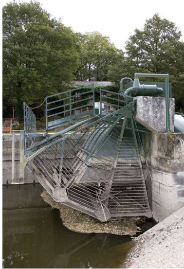
L'extrémité nord de la micro-centrale hydroélectrique vue de côté, depuis l'amont, pendant les écourues de 2009.
