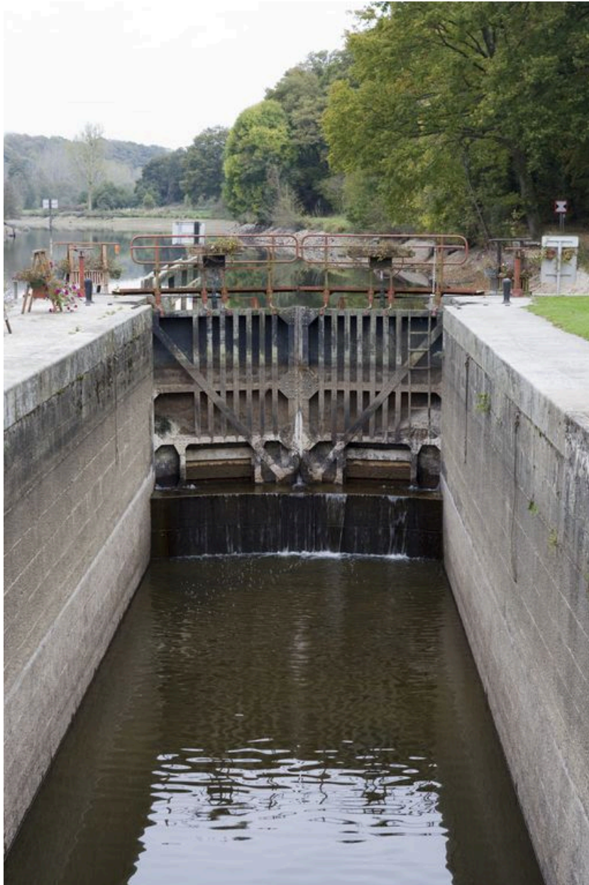
Le sas de l'écluse et la porte amont vus depuis le sud, pendant les écourues de 2009.
