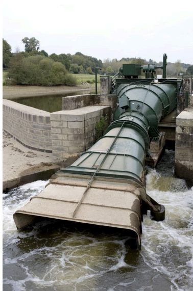
La micro-centrale hydroélectrique vue de face depuis l'aval, pendant les écourues de 2009. Phot. Yves Guillotin IVR52_20095300446NUCA
