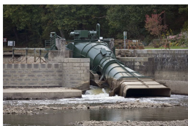
La micro-centrale hydroélectrique vue de trois-quarts depuis l'aval, pendant les écourues de 2009. Phot. Yves Guillotin IVR52_20095300454NUCA
