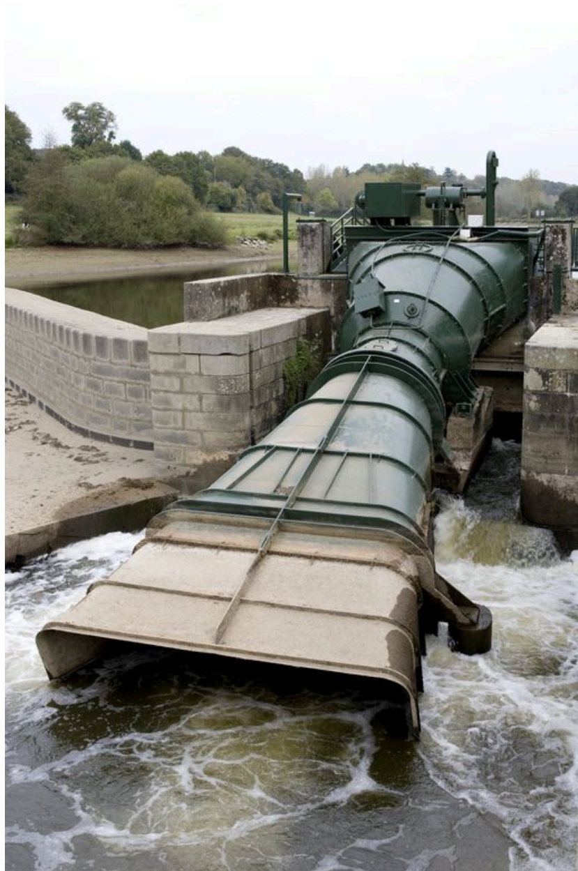
La micro-centrale hydroélectrique vue de face depuis l'aval, pendant les écourues de 2009.
