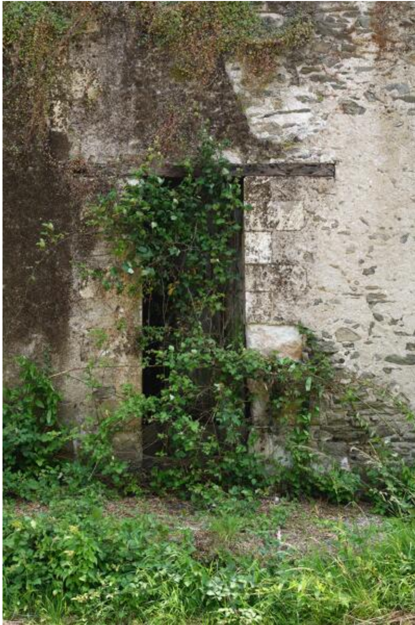
Détail d'une ouverture de logis en pierre de taille de tuffeau avec linteau en bois.
