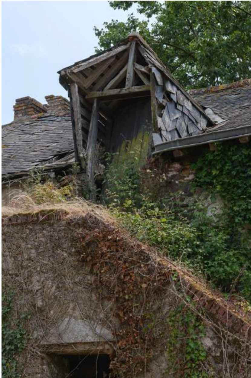
Détail de l'accès au comble à surcroît d'un des logis de la ferme du Theil.
