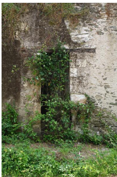
Détail d'une ouverture de logis en pierre de taille de tuffeau avec linteau en bois. Phot. Armelle Maugin IVR52_20254900673NUCA
