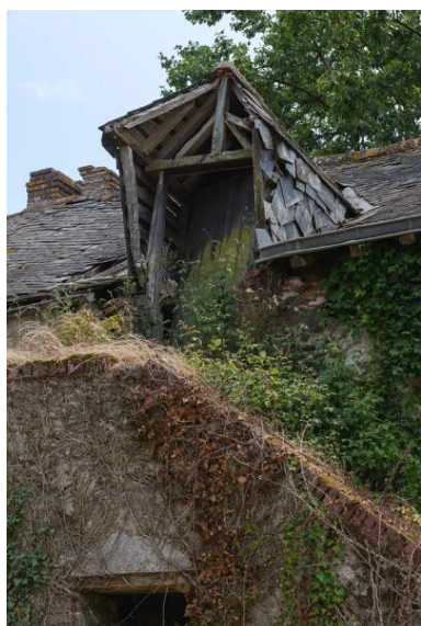
Détail de l'accès au comble à surcroît d'un des logis de la ferme du Theil. Phot. Armelle Maugin IVR52_20254900677NUCA
