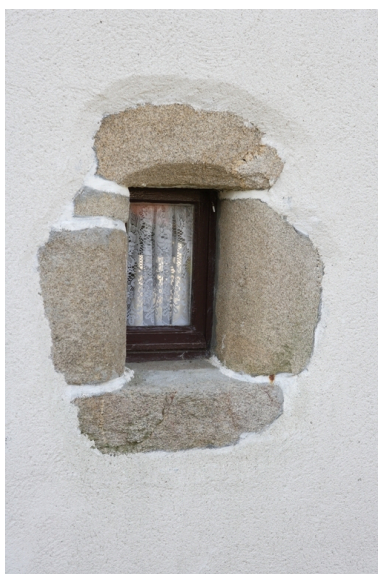
Détail du jour du rez-de-chaussée du 2e logis (2 rue de la Croix). Phot. Denis Pillet IVR52_20084400056NUCA
