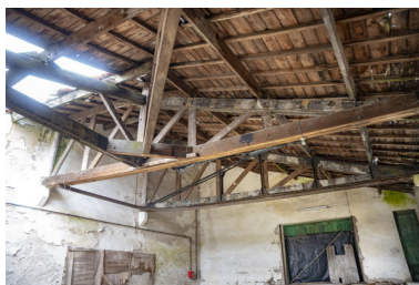
Salle dédiée au lavage des bouteilles, détail de la charpente en partie effondrée. Phot. Pierre-Bernard Fourny IVR52_20224400060NUCA
