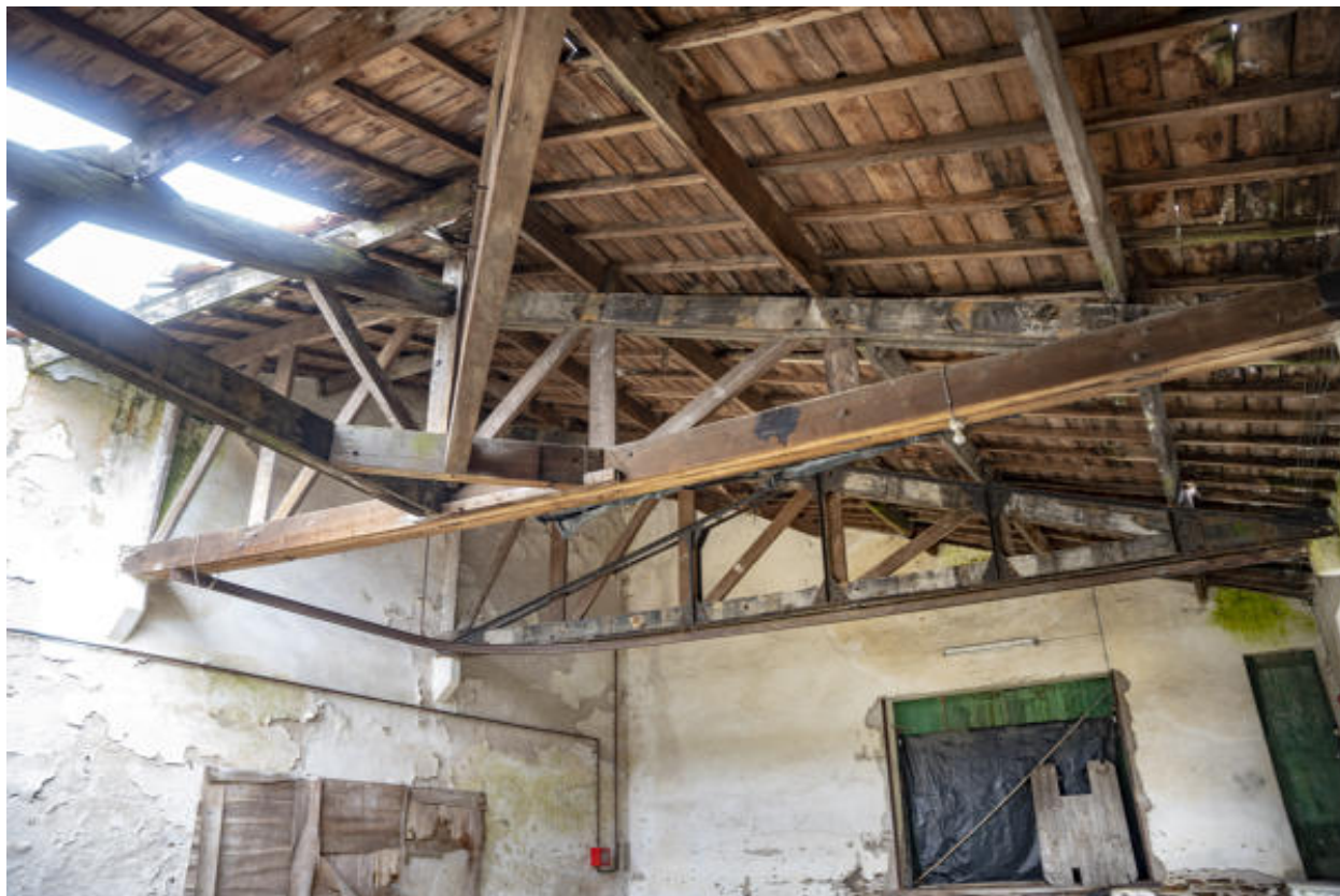
Salle dédiée au lavage des bouteilles, détail de la charpente en partie effondrée.
