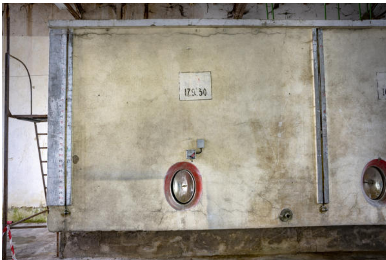
Détail d'une cuve aérienne, cuverie principale.
