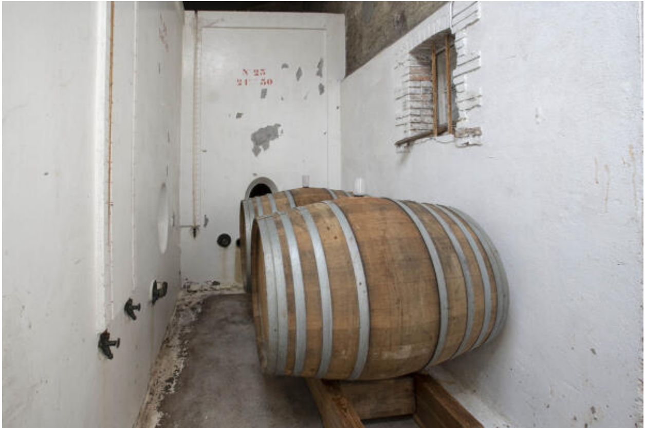
Cuves aériennes et tonneaux dans l'extension sud du bâtiment.
