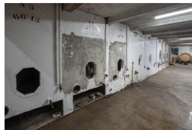
Cuves aériennes. Phot. Pierre-Bernard Fourny IVR52_20224400356NUCA
