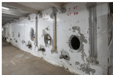
Cuves aériennes. Phot. Pierre-Bernard Fourny IVR52_20224400357NUCA
