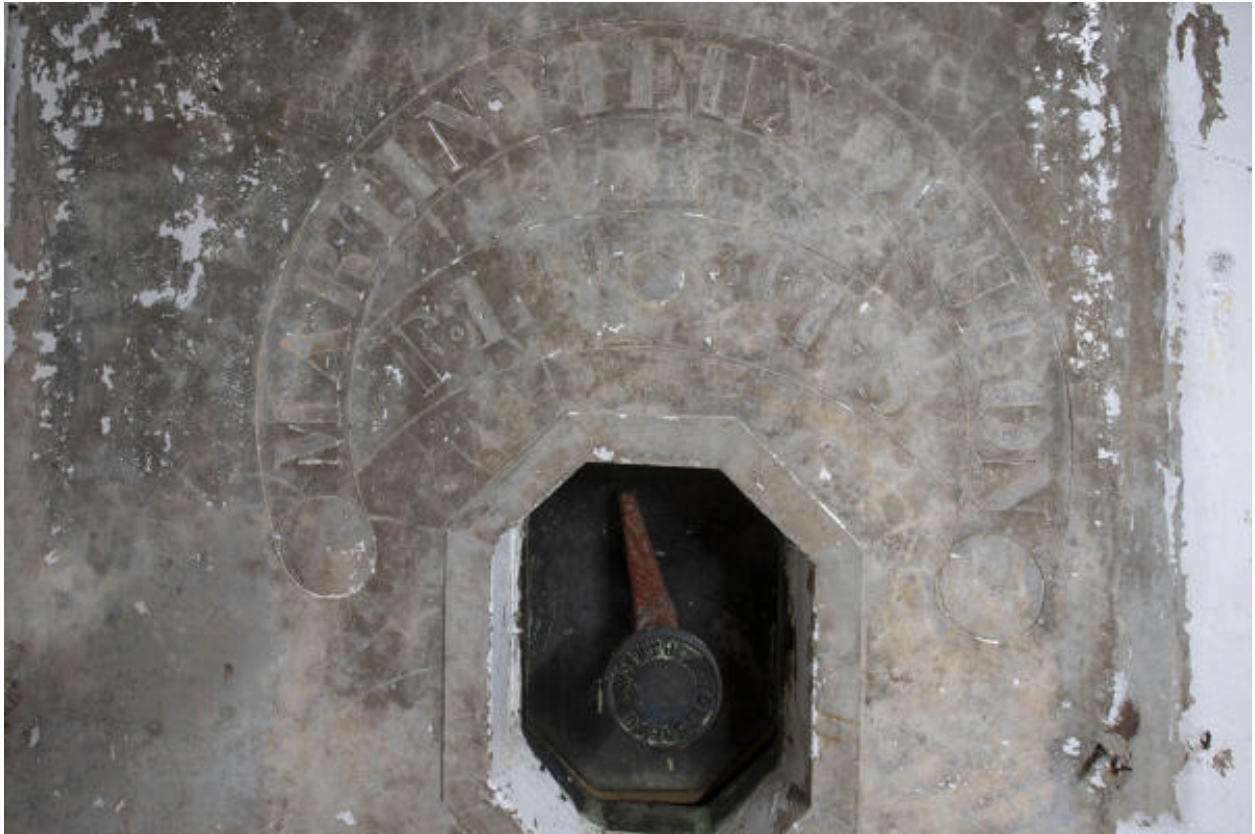
Détail d'une cuve aérienne.
