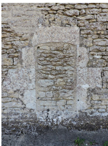
Ancienne baie murée, peut-être du 18e siècle, sur le côté nord du logis. Phot. Yannis Suire IVR52_20198503209NUCA
