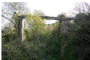
Les ruines de l'ossature bois du bâtiment situé au sud-ouest.
