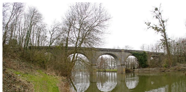
Vue d'ensemble depuis la rive gauche en amont, en hiver. Phot. François Lasa IVR52_20065300133NUCA
