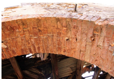
Couronnement des baies : fausses briques peintes sur de vraies briques. Phot. Jean-Baptiste Darrasse IVR52_20097200610NUCA
