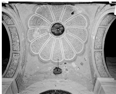
Croisée du transept, coupole : vue d'ensemble des sondages effectués à travers les peintures du XIIIe et du XIXe siècle. Phot. Patrice Giraud IVR52_19924900879X
