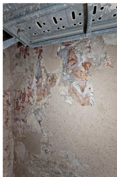
Bras nord du transept, mur est, côté nord. Couche picturale avec des cavaliers recouvrant le décor des années 1200. Phot. Yves Guillotin IVR52_20144900151NUCA
