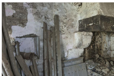
Corbeau gauche et niche de la cheminée sud. Phot. Yves Guillotin IVR52_20185300506NUCA
