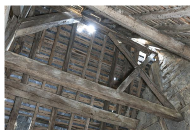
Croix de Saint-André entre les deux fermes de charpente. Phot. Yves Guillotin IVR52_20185300507NUCA
