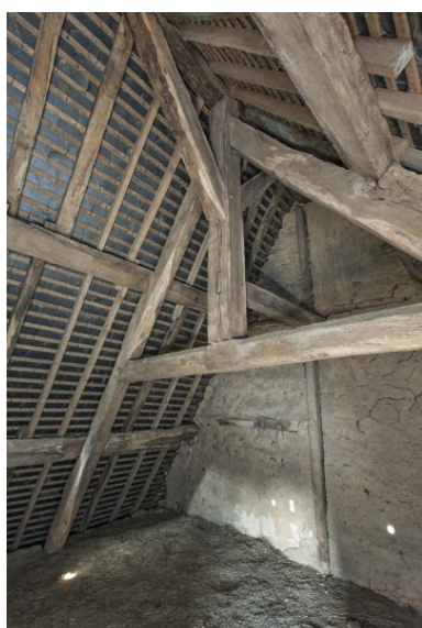
Maison de Bignon, ferme sud de la charpente. Phot. Yves Guillotin IVR52_20185300503NUCA
