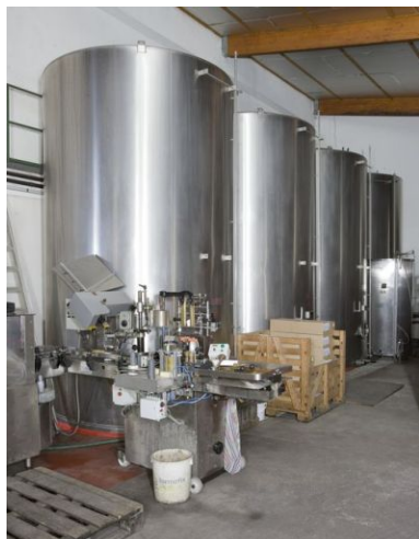
La dépendance est, extension sud : les cuves de vinification en inox.
