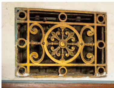
Une plaque du système de chauffage.
