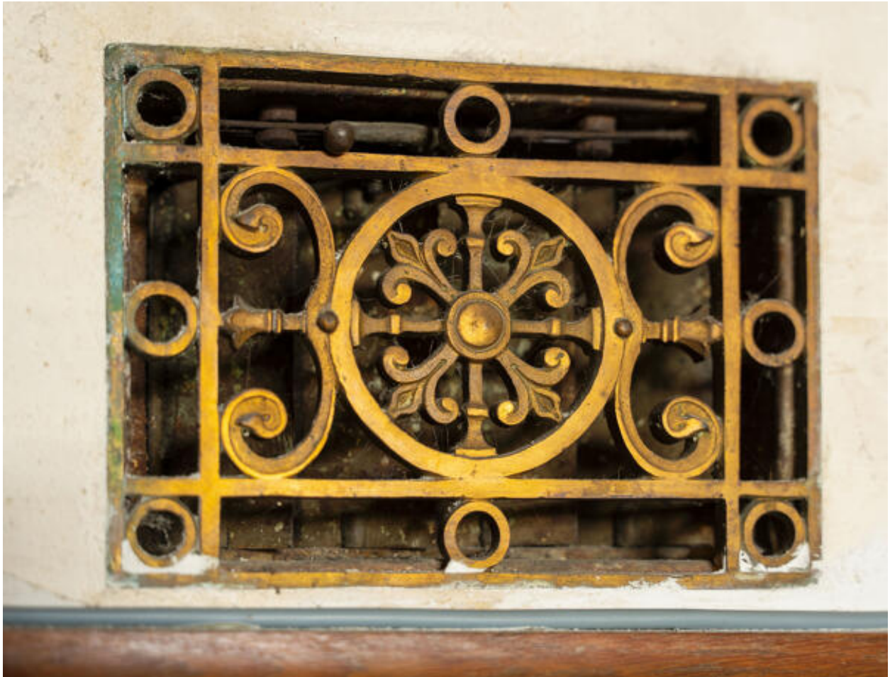
Une plaque du système de chauffage.
