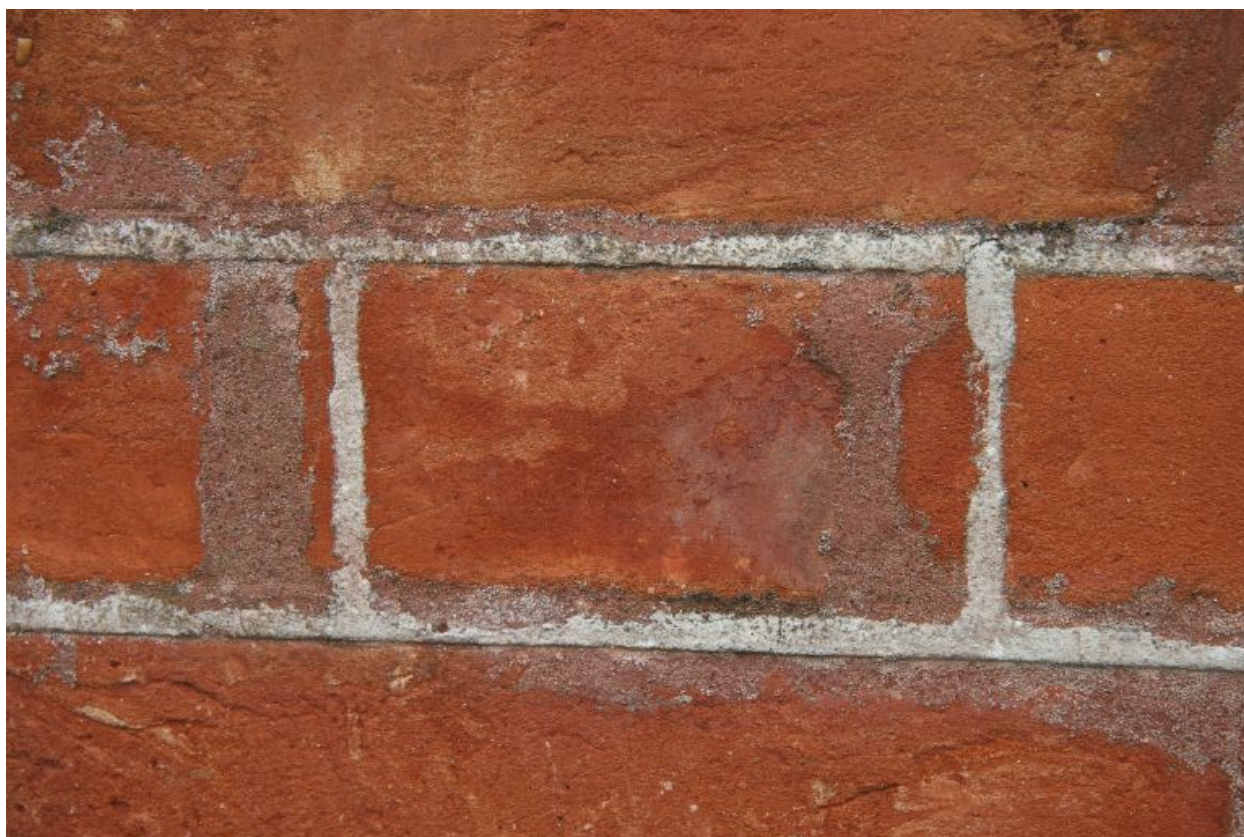
Faux joints dans un enduit fausse brique.
