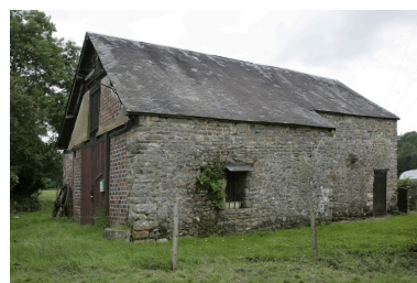
L'ancien logis, puis étable, vu depuis le nord-est. Phot. François Lasa IVR52_20075300402NUCA
