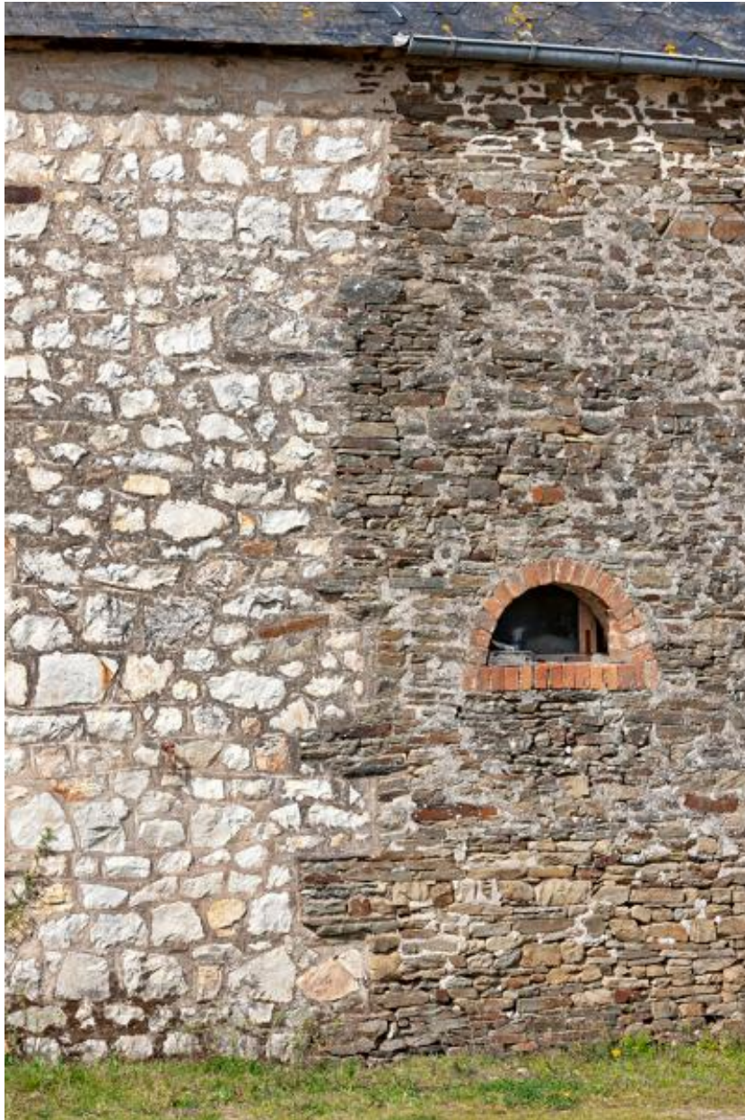
Corps de bâtiment nord-ouest, mur sud, jonction entre la maçonnerie en moellon de grès blanc et en moellon de grès.
