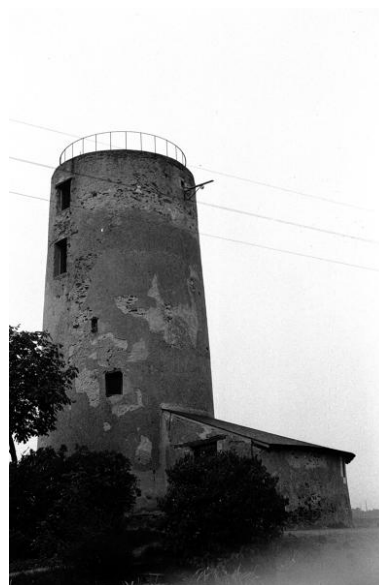
Moulin-tour du Lion dit Moulin-Neuf, avant restauration de sa toiture, Montjean-sur-Loire. Phot. Marie-Anne Eon IVR52_19724900387Z
