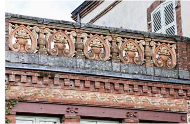
Détail du garde-corps du corps de logis bas. Phot. Yves Guillotin IVR52_20225300016NUCA
