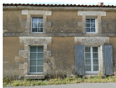
Deux des travées d'ouvertures sur la façade du logis. Phot. Yannis Suire IVR52_20228500346NUCA
