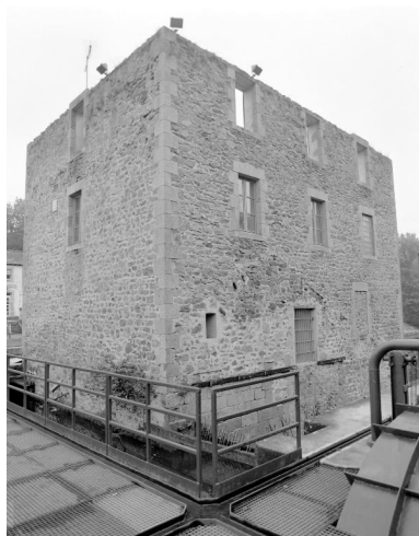
Les façades nord et ouest vues depuis la passerelle d'accès à la micro-centrale électrique. Phot. François Lasa IVR52_20025301202X
