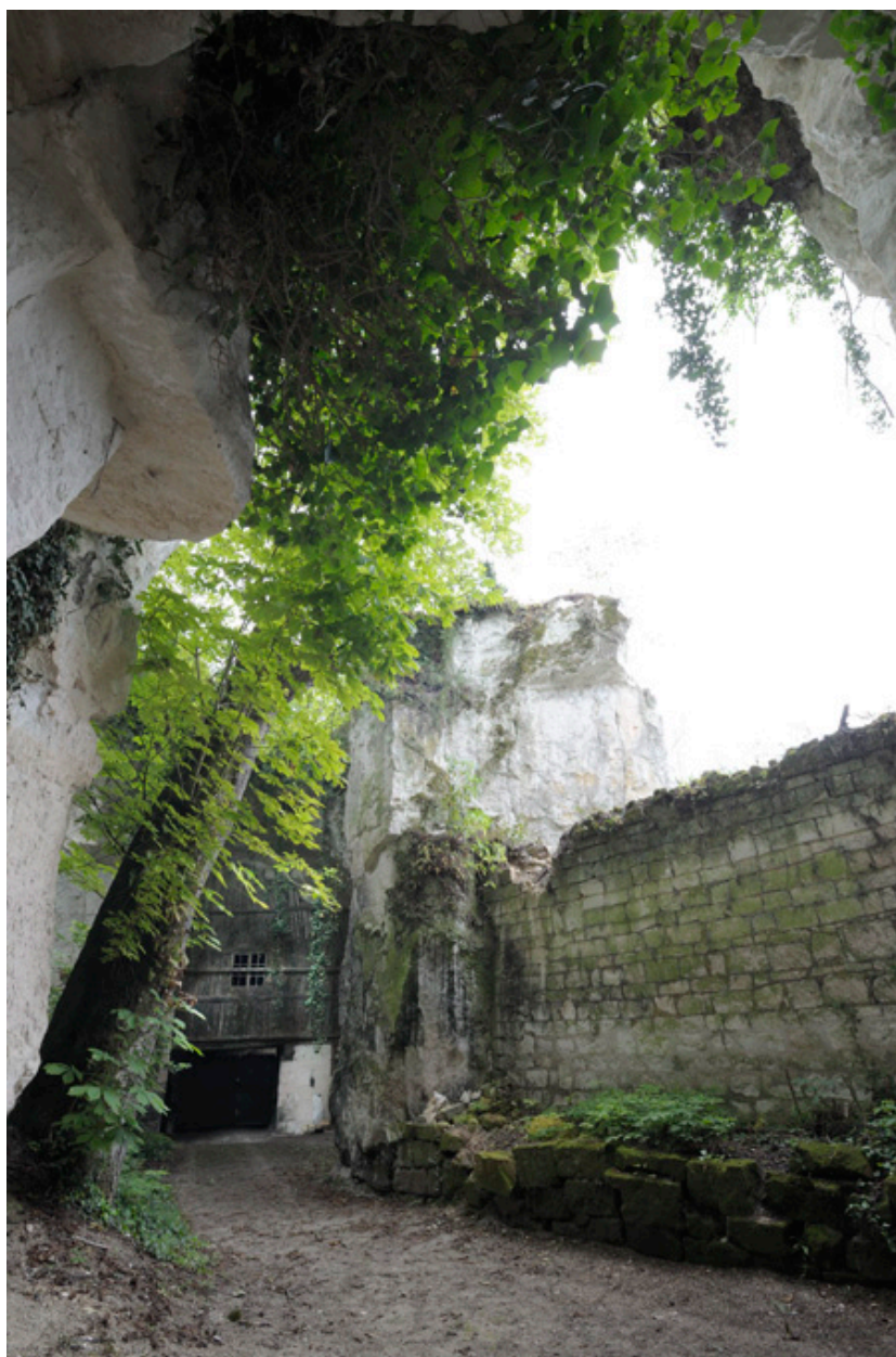
Premier fontis : vue générale, avec l'entrepôt et le mur de clôture obturant d'anciennes galeries.
