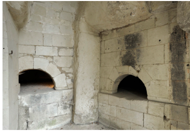
Premier fontis : cavité latérale, avec détail des 2 fours (nord à droite, ouest à gauche).
