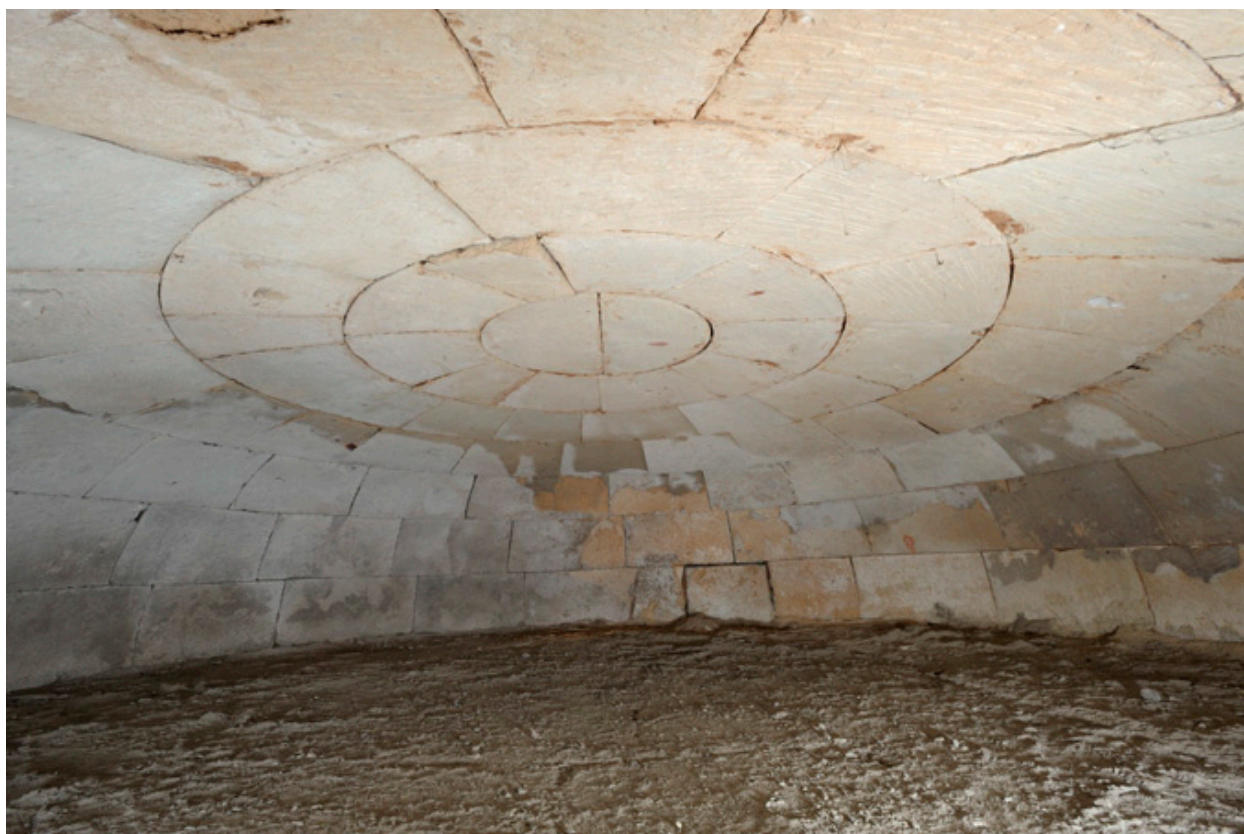
Premier fontis : cavité latérale, voûte du four nord.
