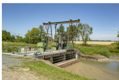
Les pompes de la Grande cabane. Phot. Pierre-Bernard Fourny IVR52_20208501278NUCA
