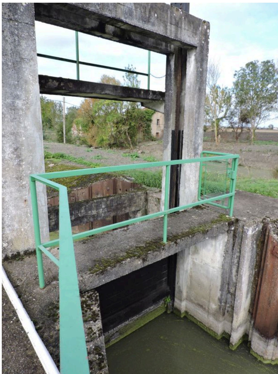
Le pertuis nord avec vanne verticale à crics à crémaillères.
