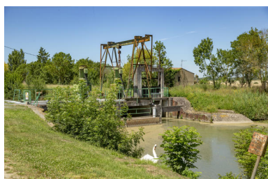
Les pompes de la Grande cabane. Phot. Pierre-Bernard Fourny IVR52_20208501277NUCA
