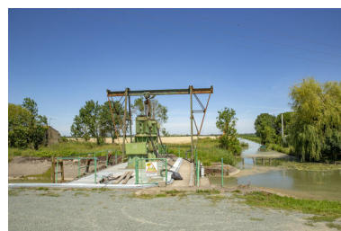
Les pompes de la Grande cabane. Phot. Pierre-Bernard Fourny IVR52_20208501279NUCA
