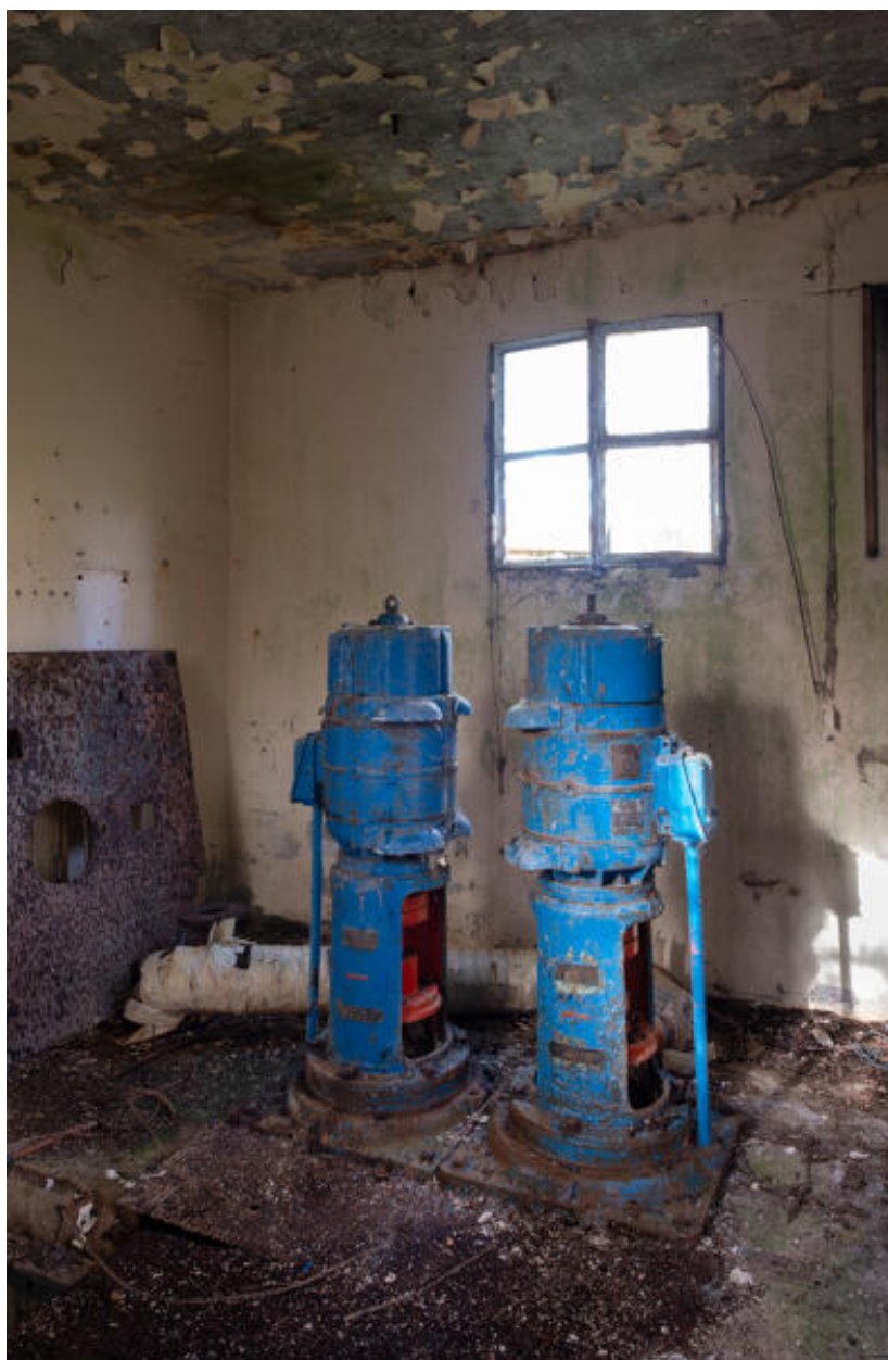
Les deux moto-pompes électriques verticales Bergeron en place dans le bâtiment de 1937.
