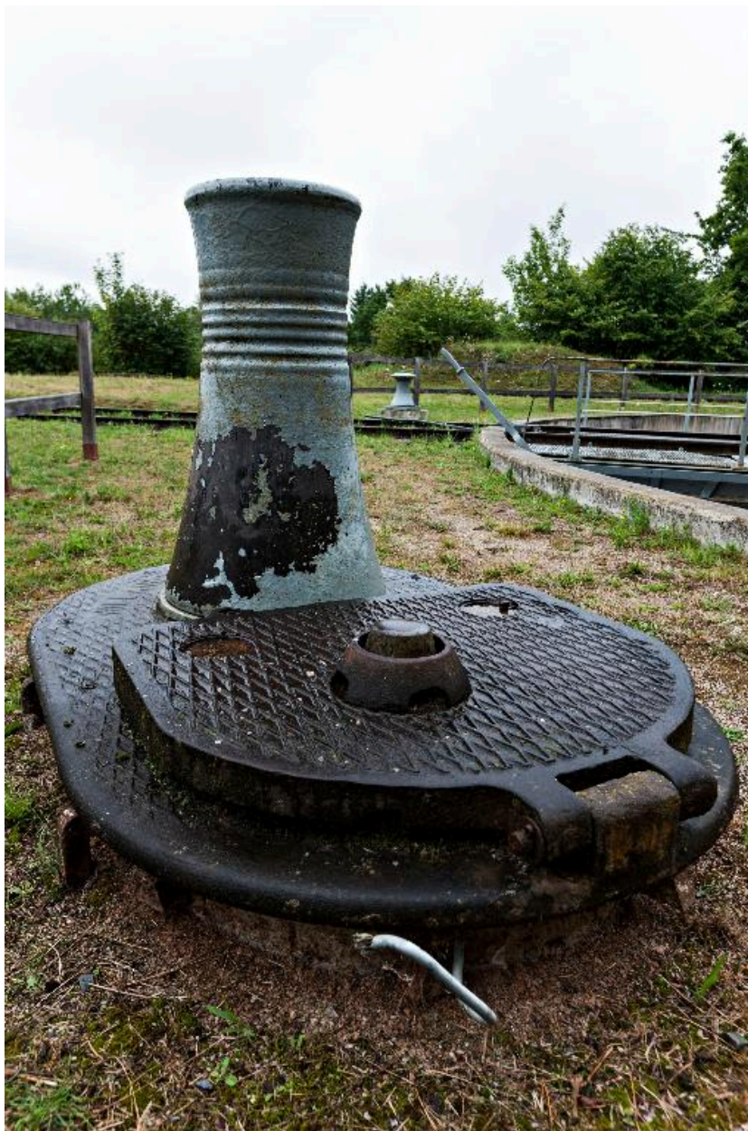
Le cabestan à moteur électrique.
