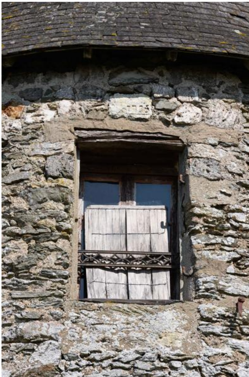
Moulin à farine dit moulin des Buttes (n° 1) ou moulin de l'Ouche-Neuve. Détail de la fenêtre ouest et de la date portée 1735.
