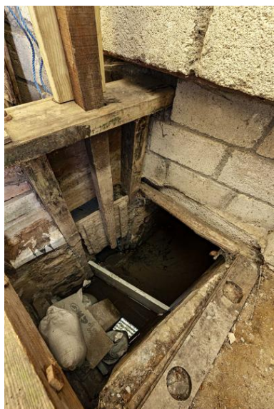
Mécanisme de contrôle des vannes. Phot. Yves Guillotin IVR52_20215300246NUCA
