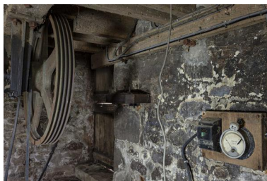
Installation électrique, soubassement. Phot. Yves Guillotin IVR52_20205300273NUCA
