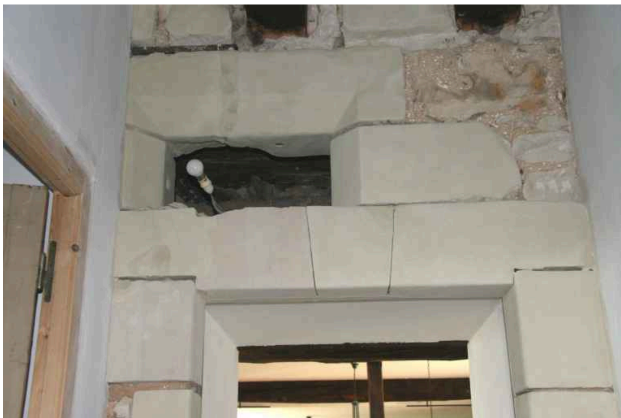
Le logis, pignon O. : vestige d'une baie.
