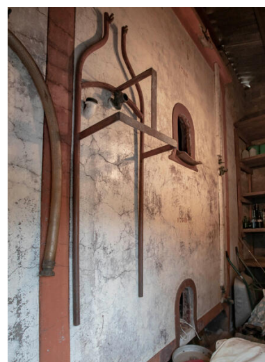
Cuve aérienne, magasin nord. Phot. Pierre-Bernard Fourny IVR52_20224400378NUCA
