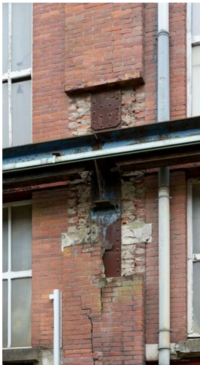
Détail de perte de décor en briques lié à l'installation d'un pont-roulant.
