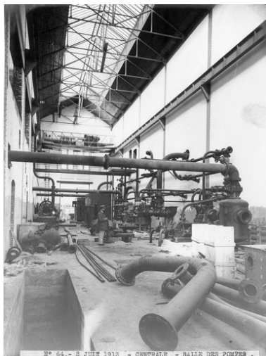
Centrale électrique de Chantenay : la salle des pompes, bas-côté sud de la grande halle. Phot. Patrick (reproduction) Jean IVR52_20134400845NUCA
