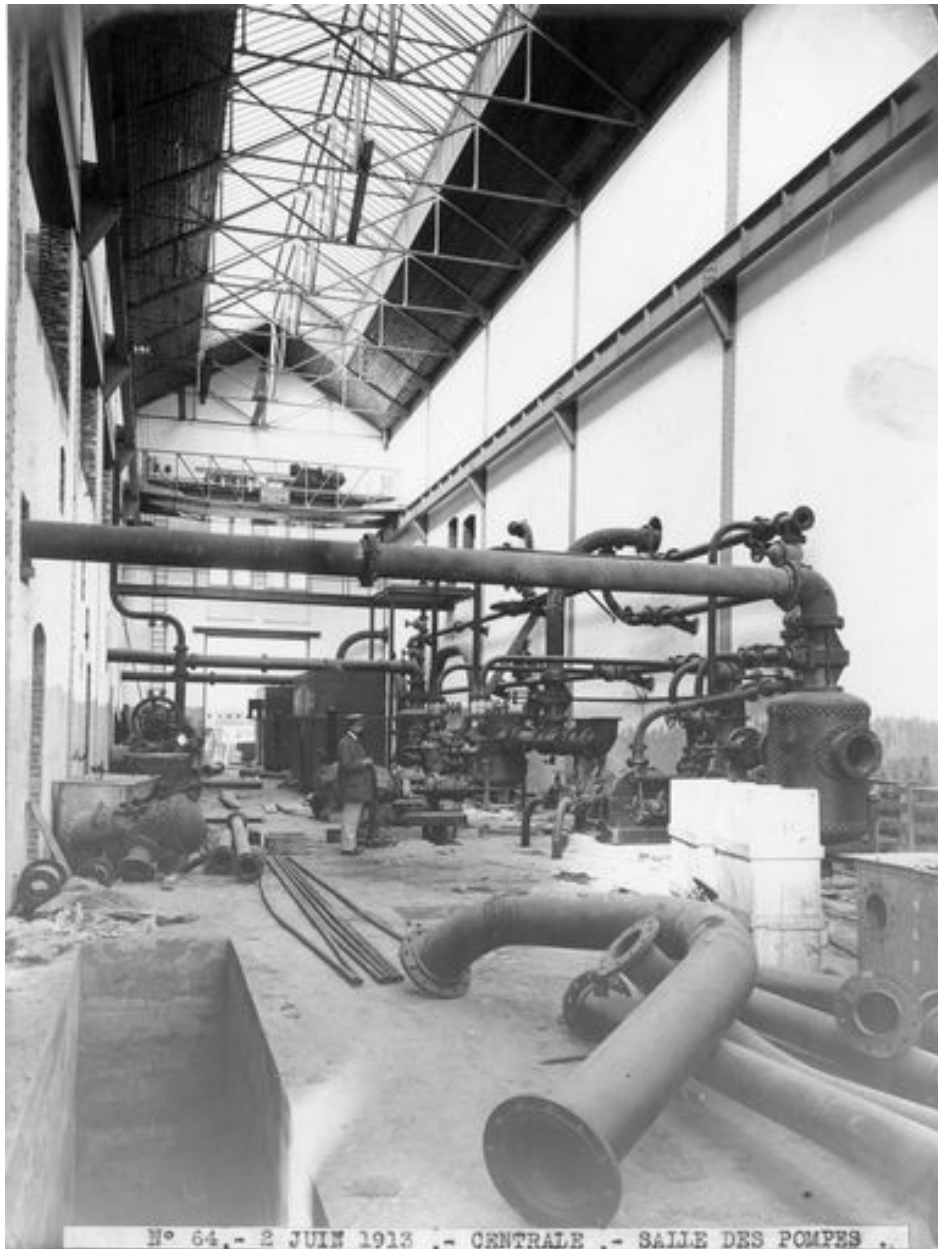
Centrale électrique de Chantenay : la salle des pompes, bas-côté sud de la grande halle.
