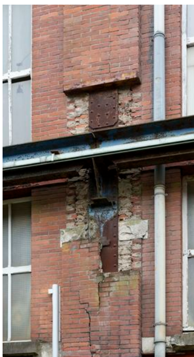
Détail de perte de décor en briques lié à l'installation d'un pont-roulant. Phot. Denis Pillet IVR52_20134401464NUCA
