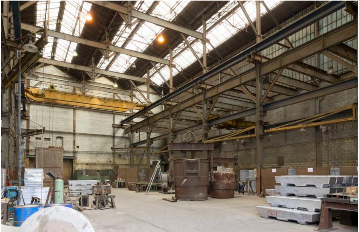
Intérieur de la chaufferie.
