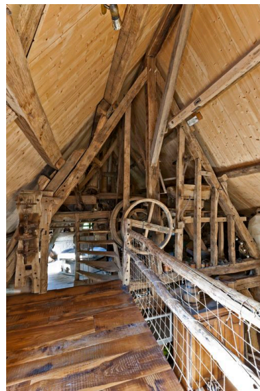
Vue intérieure de l'étage de comble du moulin. A droite, vestige du blutoir ? Phot. Yves Guillotin IVR52_20137200463NUCA
