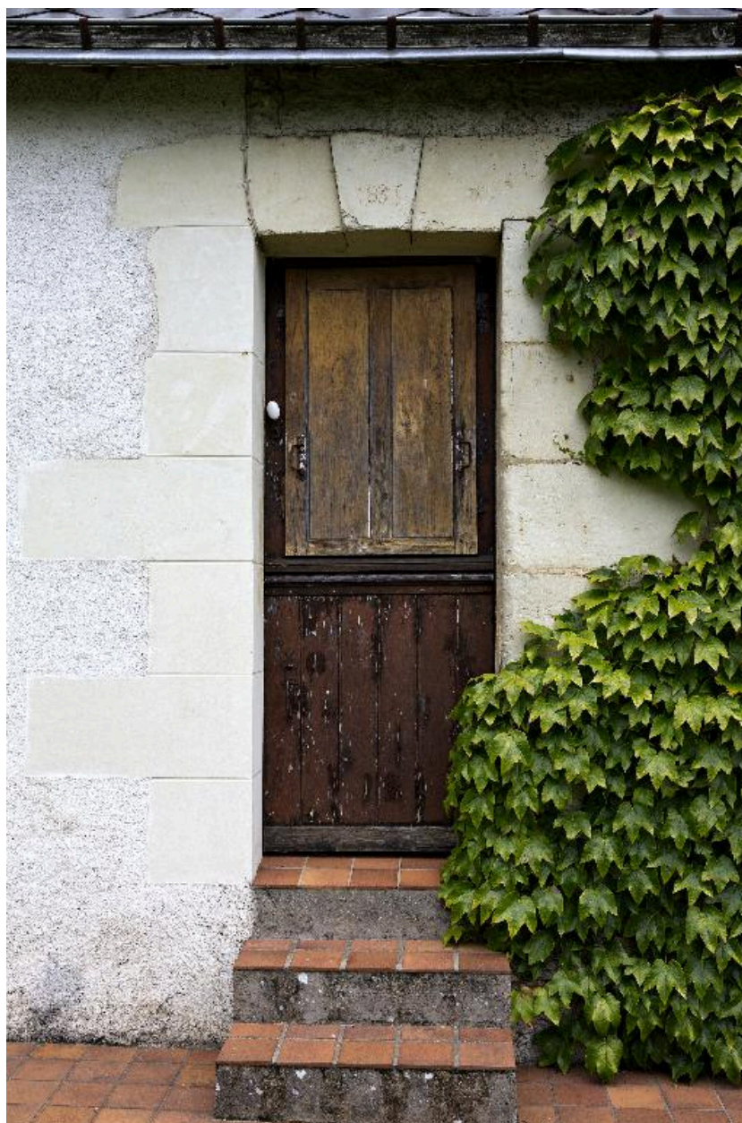
Porte de la maison. Date gravée sur la clé de la plate-bande : 1835.
