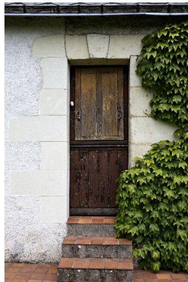
Porte de la maison. Date gravée sur la clé de la plate-bande : 1835. Phot. Pierre-Bernard Fourny IVR52_20147200491NUCA
