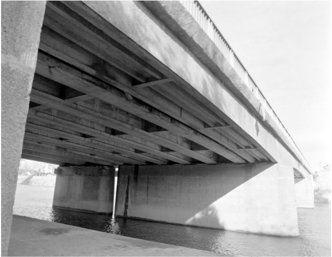
Vue de la structure du pont, sous le tablier, depuis la rive droite.
