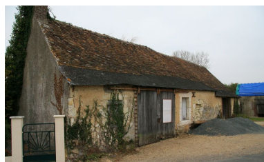
La maison éventrée par une porte de garage. Phot. Jean-Baptiste Darrasse IVR52_20077202490NUCA
