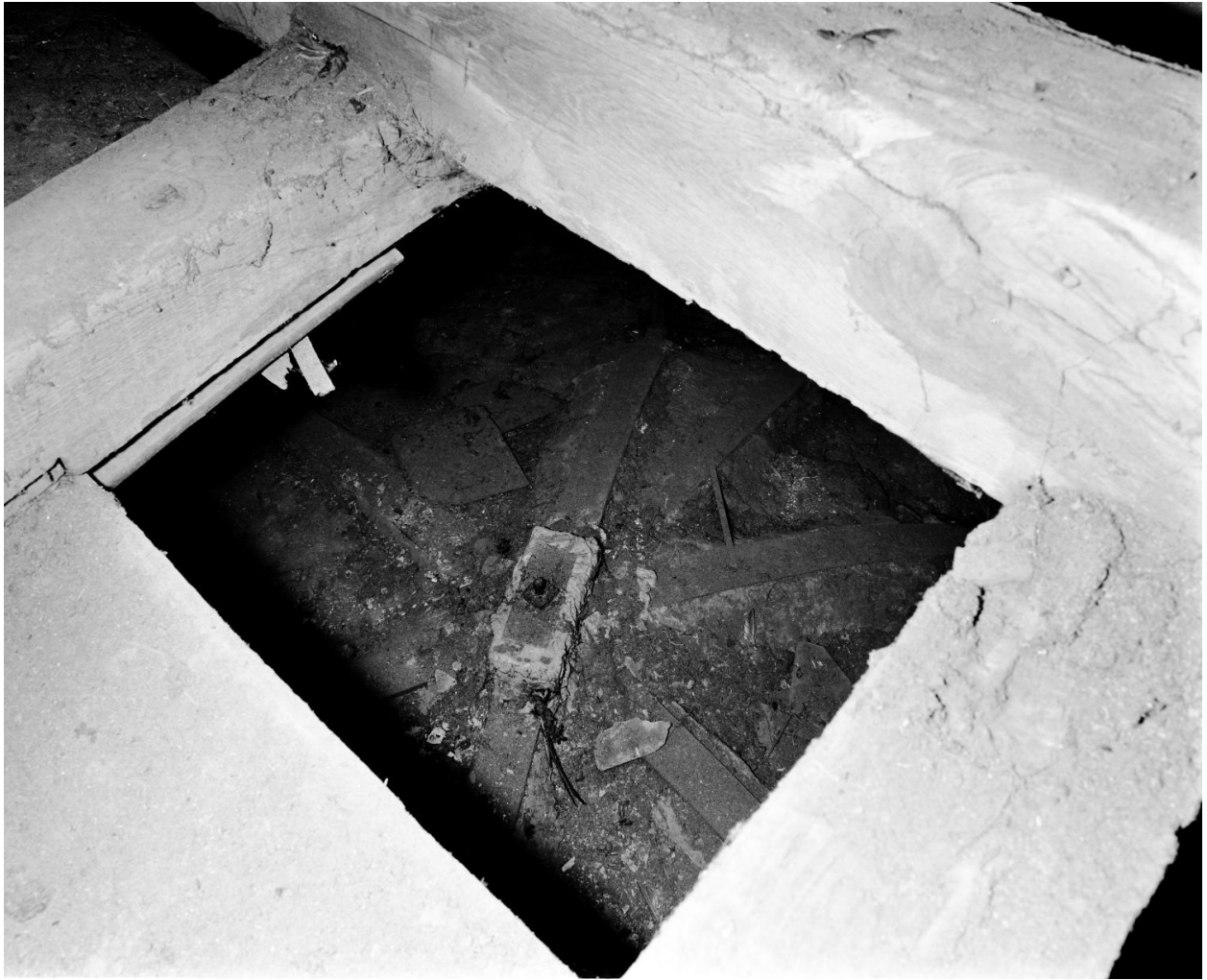
Eglise, l'une des voûtes de la nef : détail sur le cerclage métallique épousant les nervures, à l'extrados.
