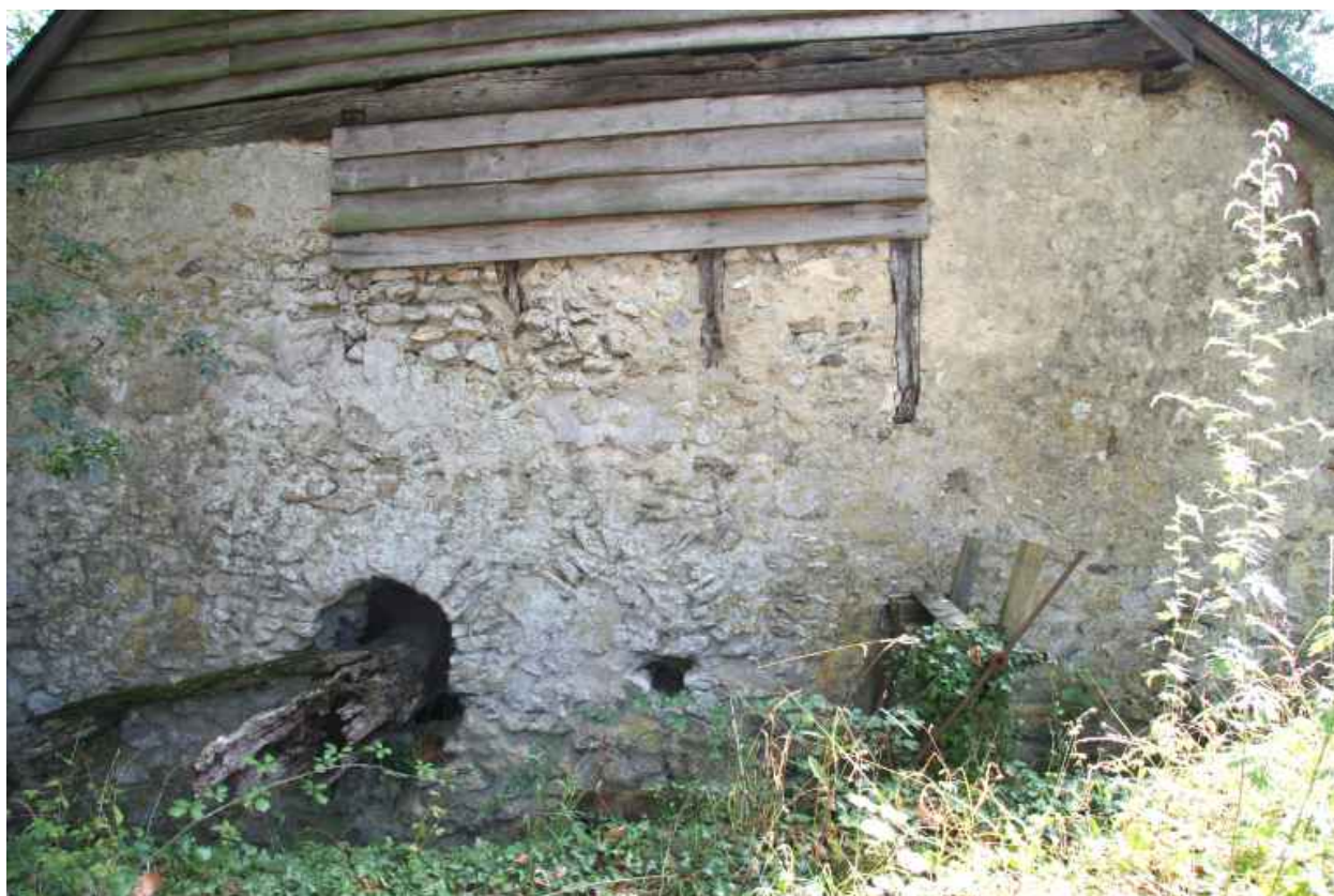
Pignon du moulin : vestige d'un pan-de-bois ?
