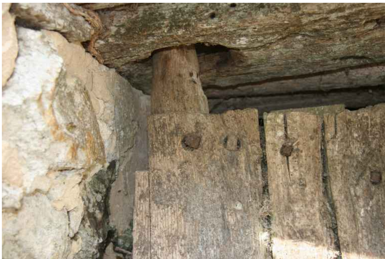
Porte d'entrée, détail.
