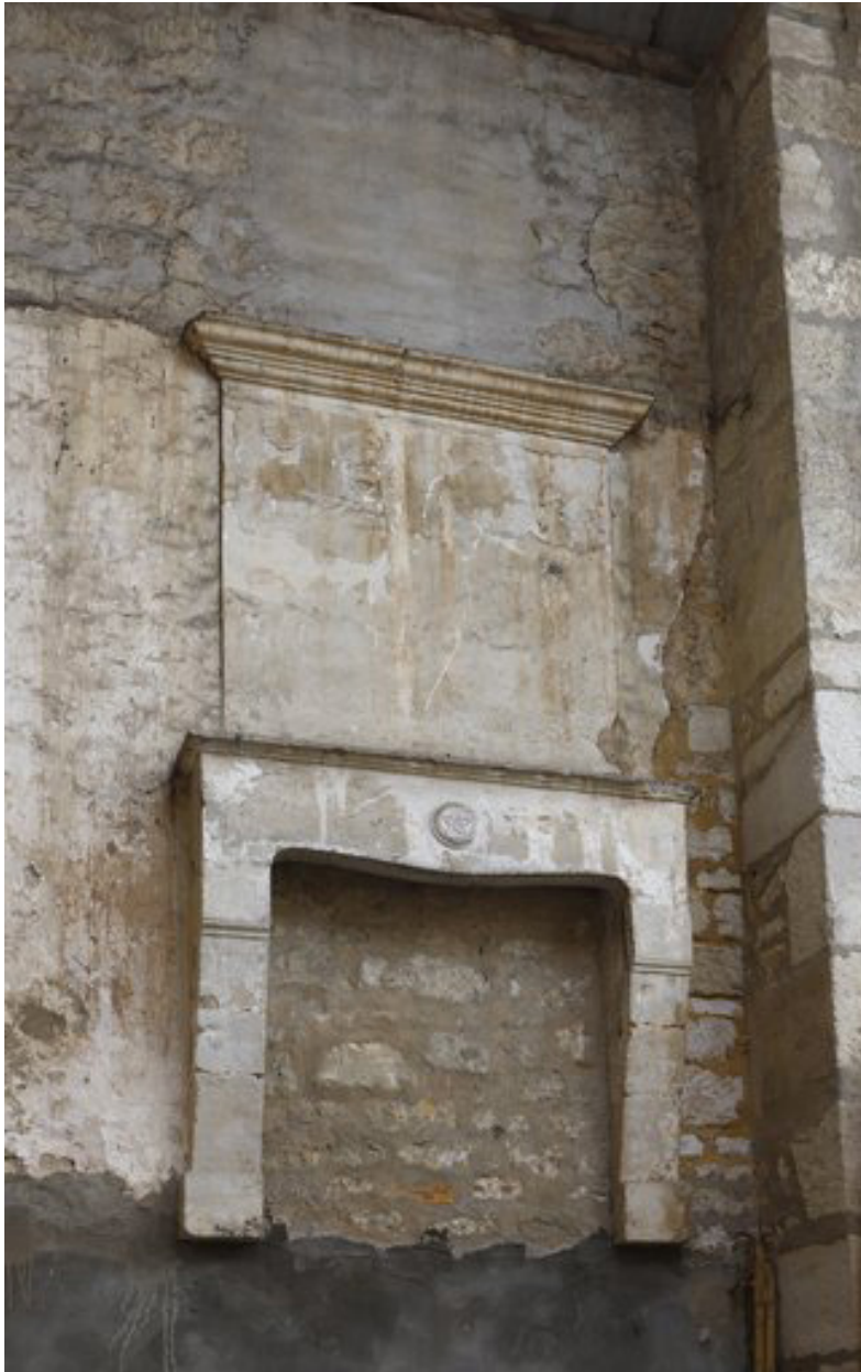
Cheminée à l'étage du bâtiment (partiellement détruit) en fond de parcelle, donnant sur la rue Emile-Zola.
