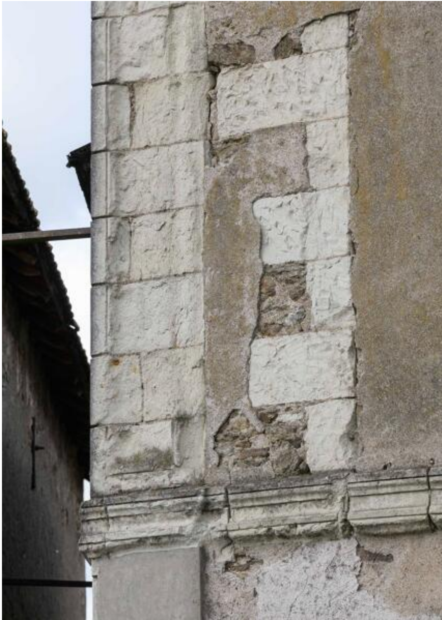
Détail d'un pilastre et d'une ancienne ouverture en pierre de taille de tuffeau.
