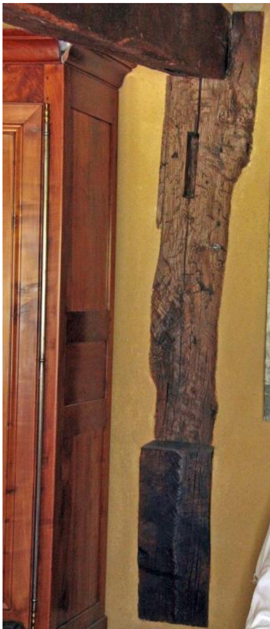
La ferme n°13 : vestige d'un poteau de bois dans le mur nord de la maison ancienne.
