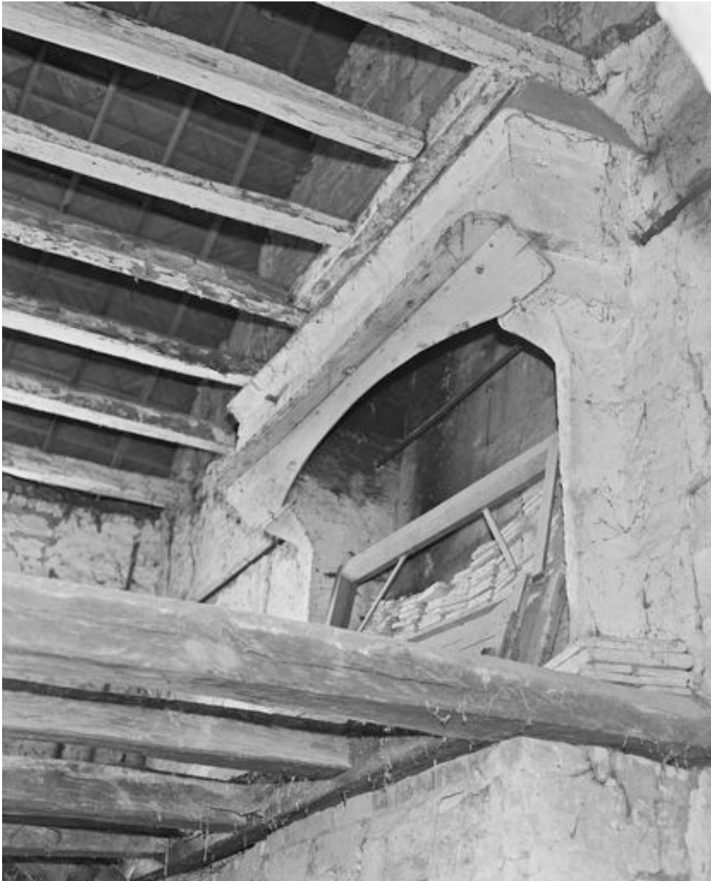
62, avenue des Roches. Cheminée du XVe siècle à l'étage-carré de la maison.
