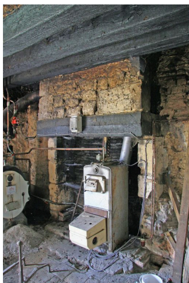
La ferme du château : cheminée. Phot. Jean-Baptiste Darrasse IVR52_20087201709NUCA
