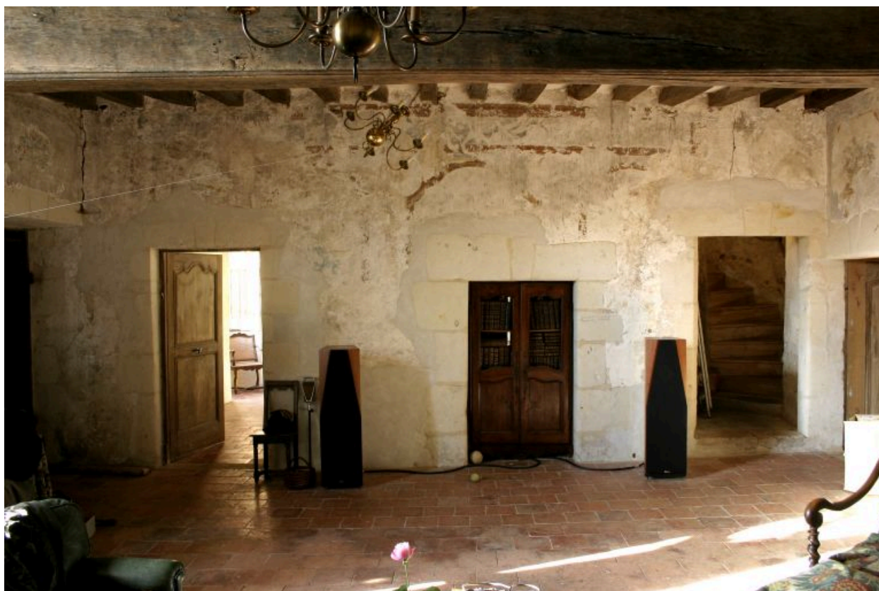
Rez-de-chaussée du logis, salle est : mur de refend avec des traces de peintures murales.
